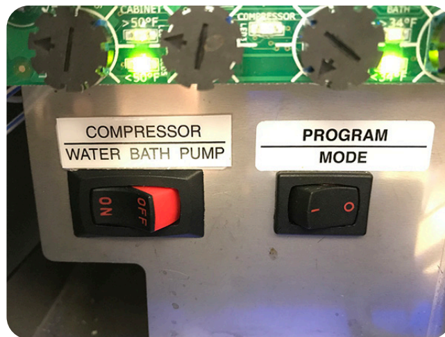
Interruptor de Refrigeración
