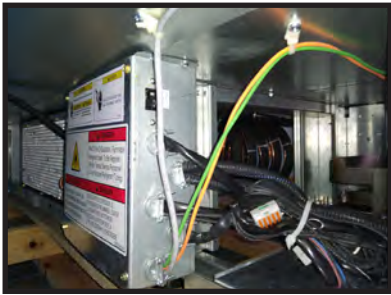
Boîte électrique de contrôleleur
