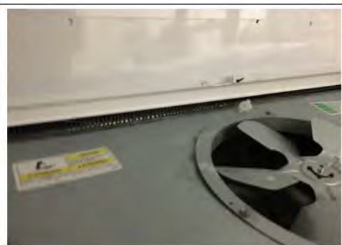
Incorrect – le serpentin d'évaporateur est visible entre le panneau et le plénum du ventilateur
