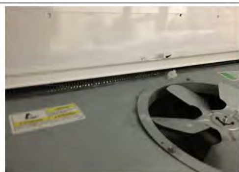
Incorrecto - el serpentín del evaporador se puede ver entre el panel posterior y el pleno de ventiladores
