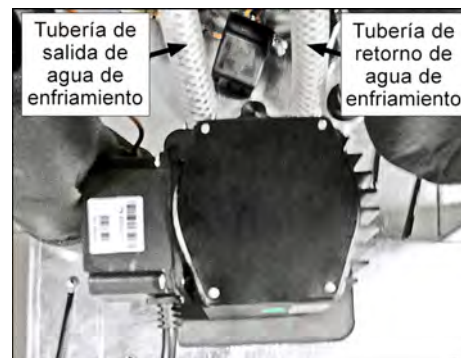
Figura 6-15 - Orientaciones de la manguera de la bomba del agitador
