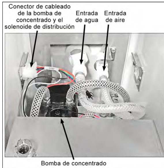
Figura 5-1 - Tubería de entrada de aire
