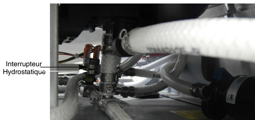
Figure 51. Vue de l'interrupteur hydrostatique
