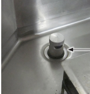
Drain Stand Pipe
